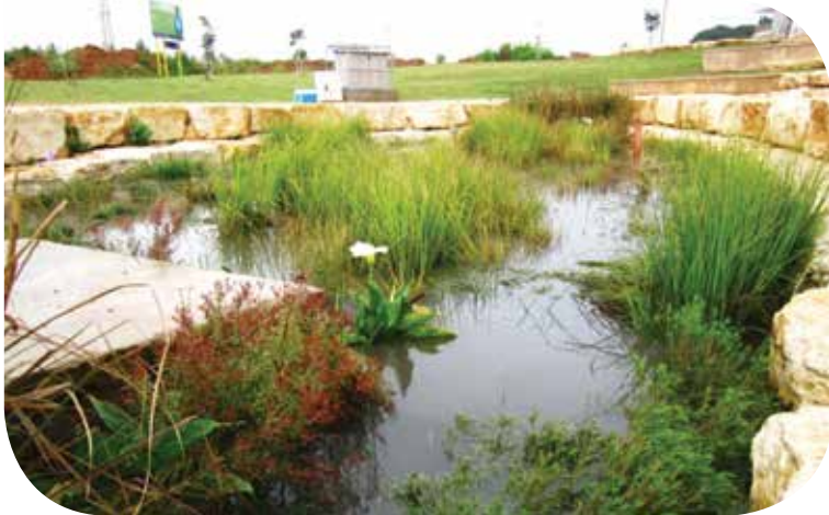
איור 3: הביופילטר לאחר אירוע גשם
